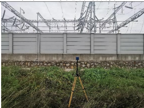
万泉330kV变电站厂界西侧7#
