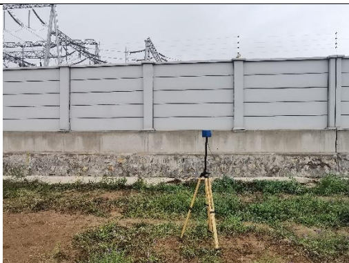
万泉330kV变电站厂界南侧5#
