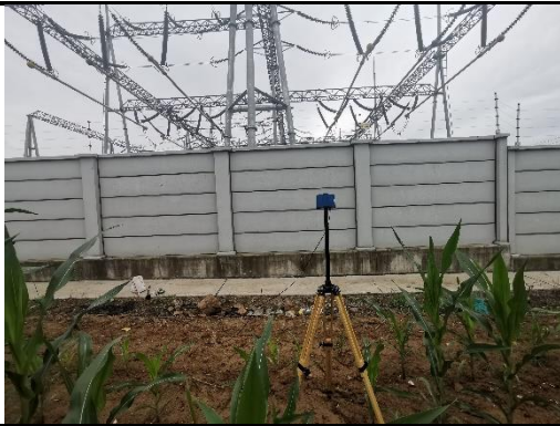
万泉330kV变电站厂界北侧1#
