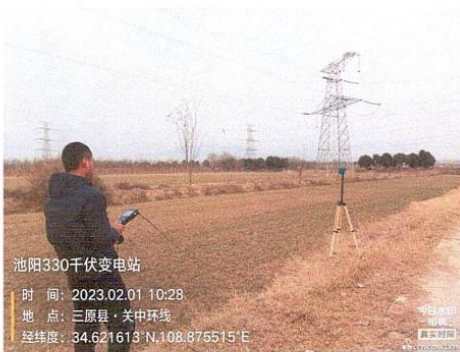
池阳 330kV 变电站西厂界
